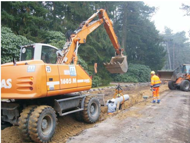
Erneuerung der Straßen und Siele im historischen Kernbereich des Ohlsdorfer Friedhofs mit altem Baumbestand
